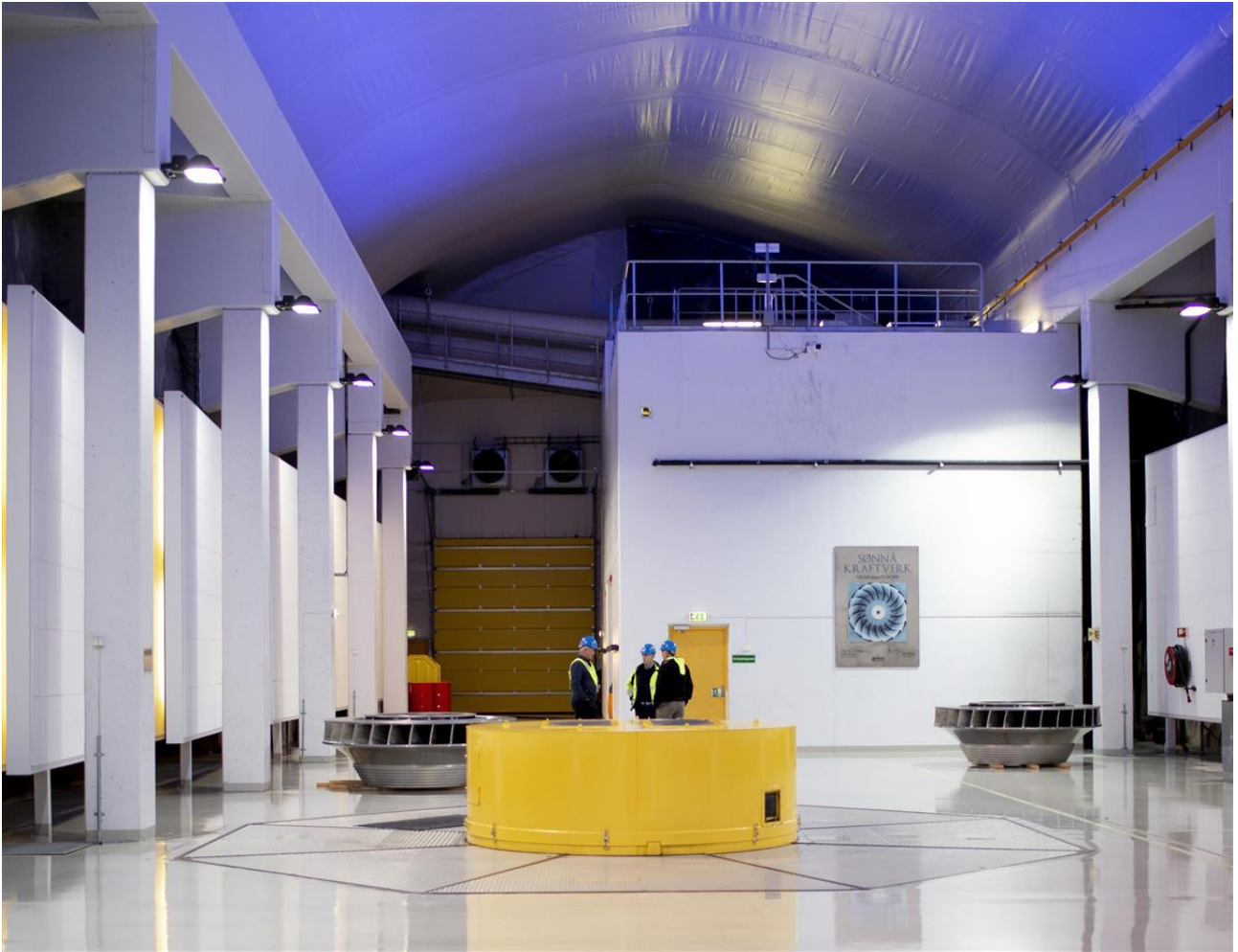
Sønnå kraftverk i Sauda kommune.
