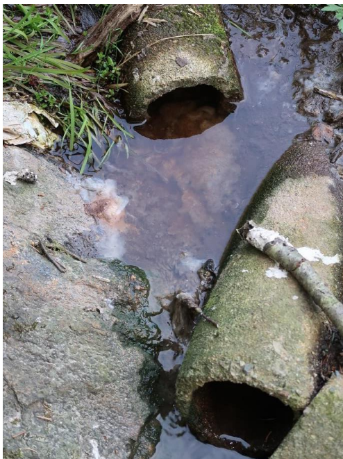
Figur 16: Avløpsrør fra spredt bebyggelse. Foto: Helge B. Pedersen /Norma vannområde
