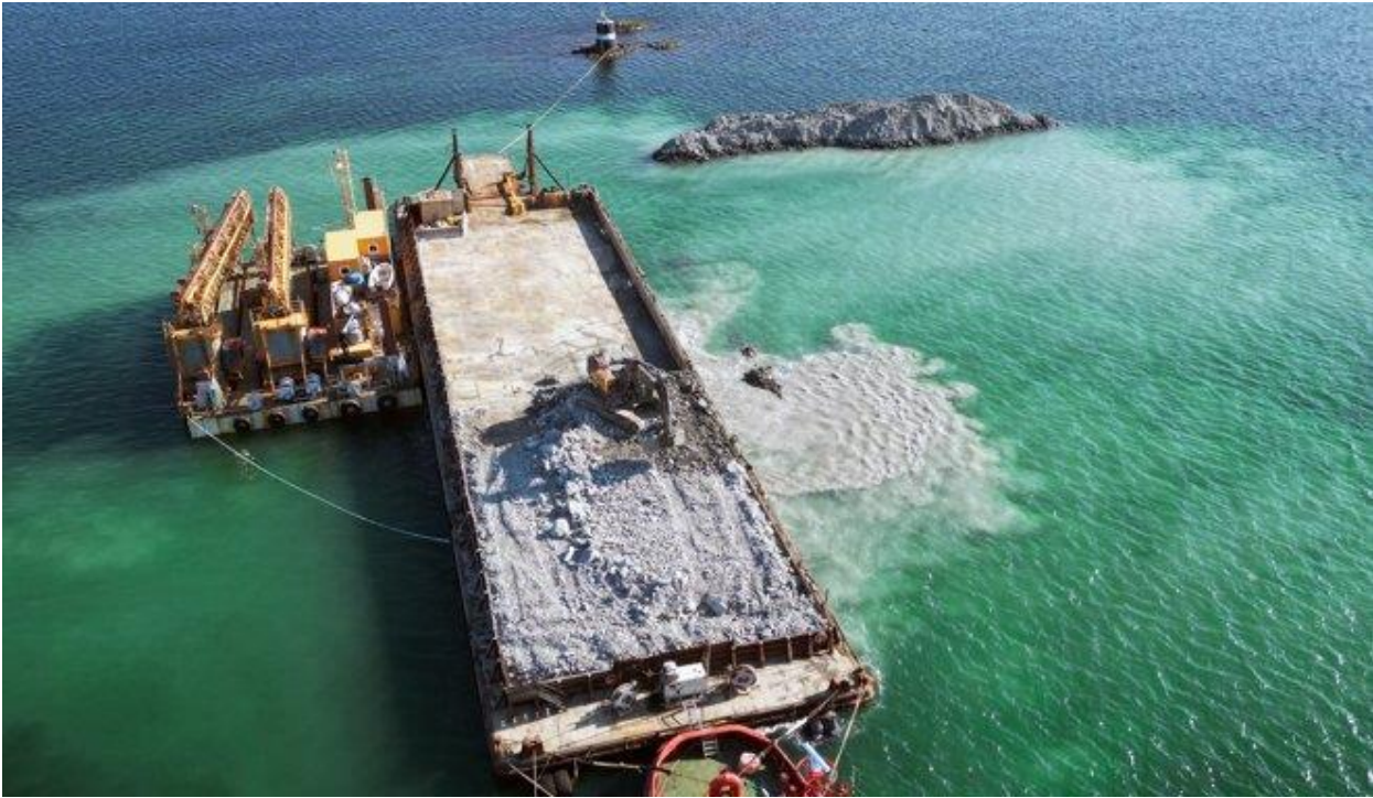
Figur 21: Utlegg av noe av de enorme mengdene med masser fra Rogfast tunnelen, som til nå blir plassert som en ny begynnende øy ved Bokn. Foto: Øyvind Ellingsen, Statens vegvesen.
